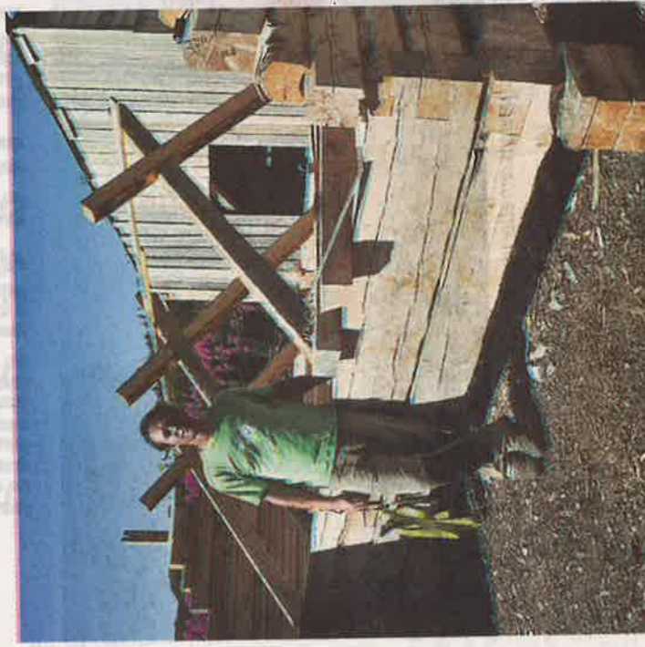
REKONSTRUKSJON: Gouallo med rekonstruksjonen av et gammelt saltfisklager som sto på Olenilsøy i Moskenes.
